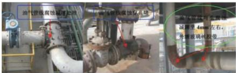
图3 1.5 Mt/a A常压塔顶油气系统腐蚀情况
