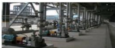
图6 干净整洁的机泵现场
